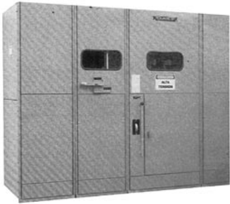
Fig. 1 Subestación compacta S2
